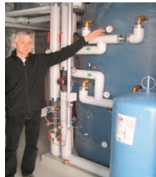
Franz Landolt vor dem grossen Boiler, der durch Sonnenenergie und Erdgas aufgeheizt wird.
