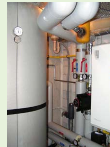
Auf kleinstem Raum ist die Gasheizung für die einzelnen MFH untergebracht.
